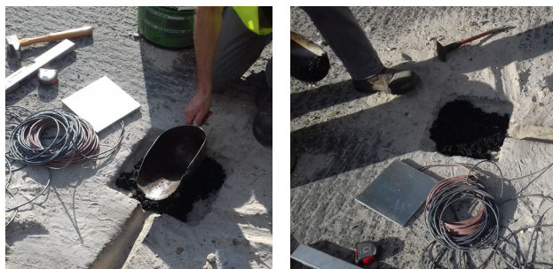
Capteurs thermiques chaussée
